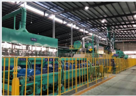
闭口桶生产线
